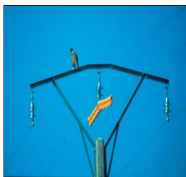
Foto 34 b. Funda aislante en un apoyo de anclaje.
